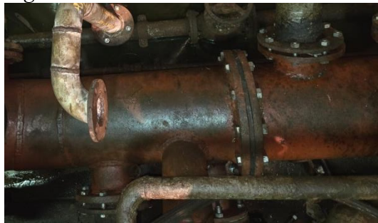
Gambar 1. Terjadinya korosi Pipa Hitam SCH 80
